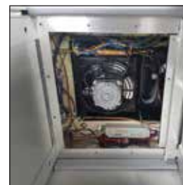
A5. Vano condensatore
